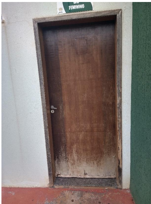
Figura 5 – Porta do banheiro
