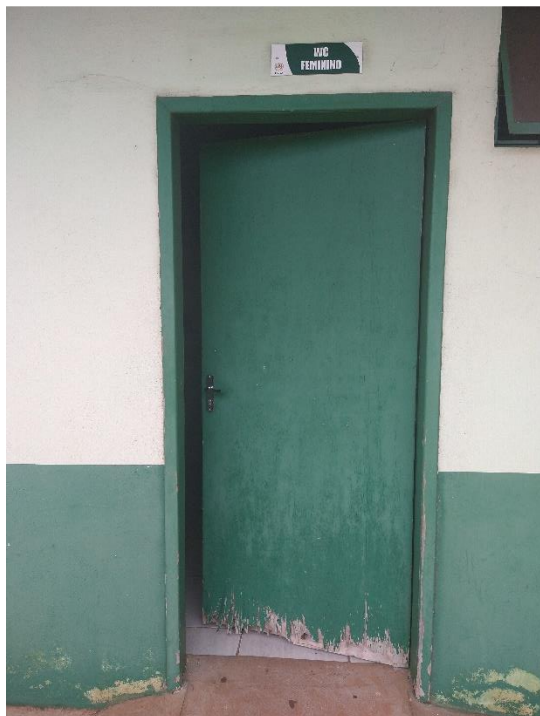
Figura 4 – Porta do banheiro
