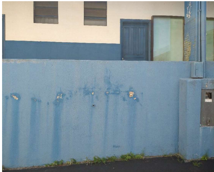
Figura 4 – Escamação da parede
