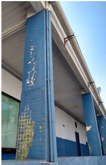
Figura 3 – Escamação do pilar
